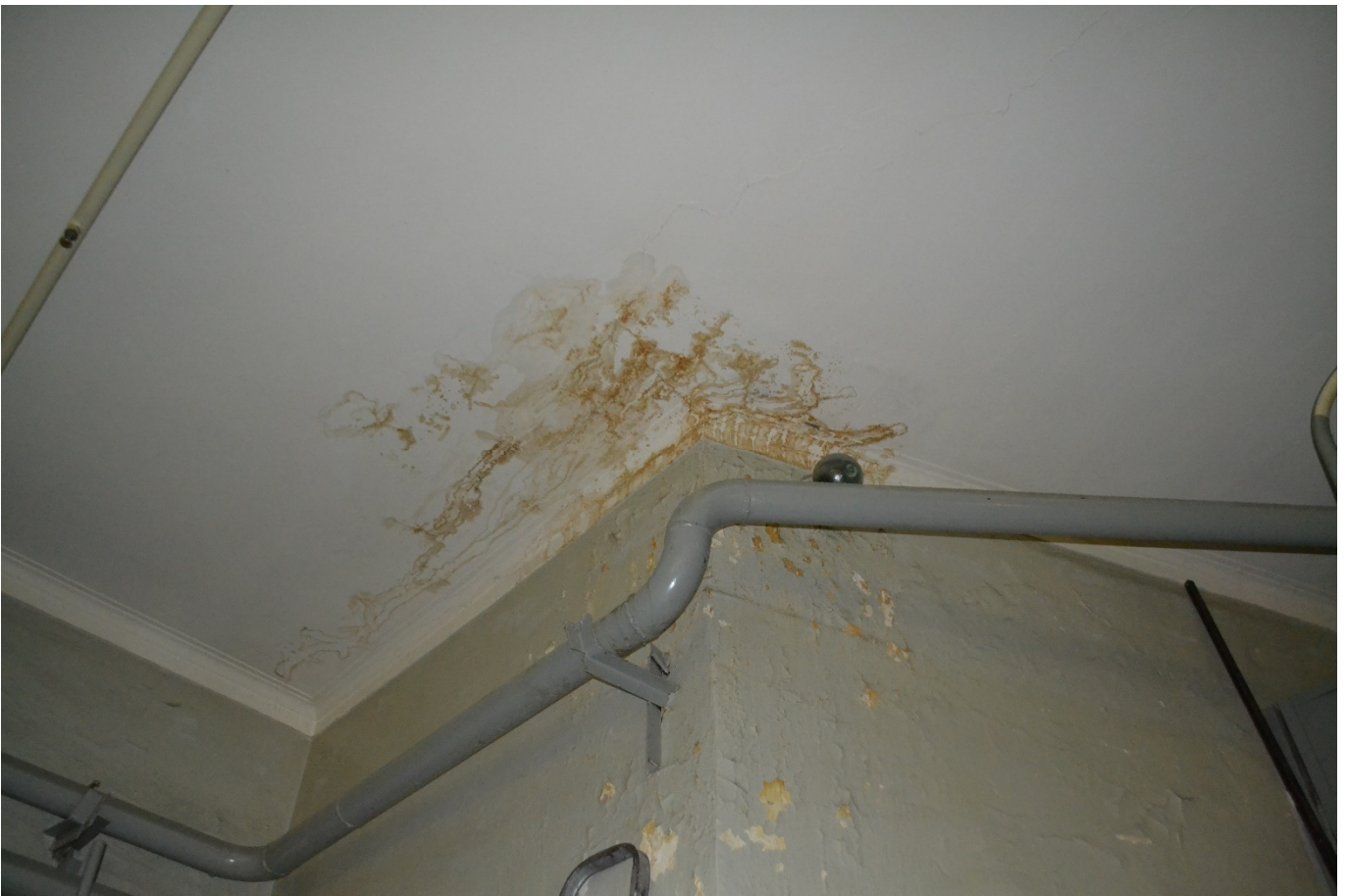
Фото 11. Следы протечек кровли.
