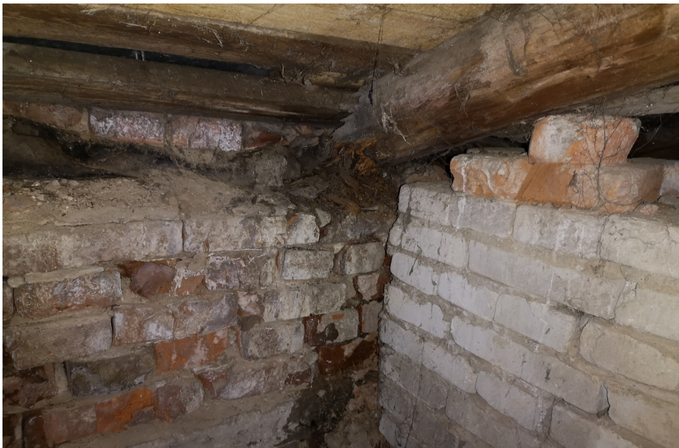
Фото 9. Разрушение мауэрлата, стропильной ноги (зона в осях 1-3/А).
