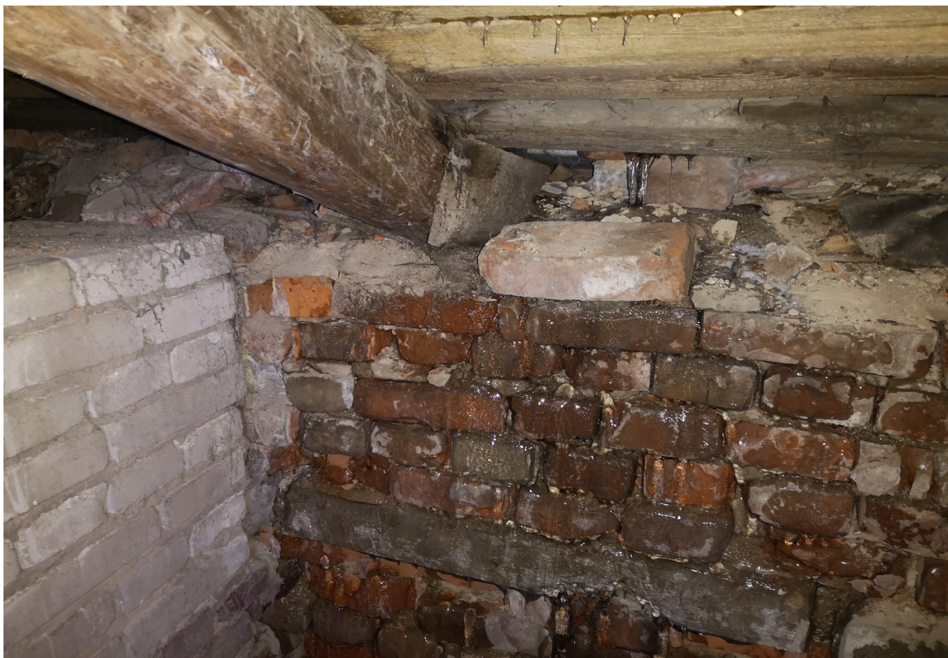
Фото 10. Разрушение мауэрлата, стропильной ноги.
