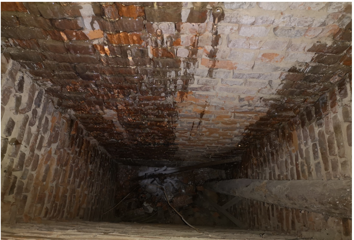
Фото 8. Замачивание стен, трещины в кирпичной кладке.
