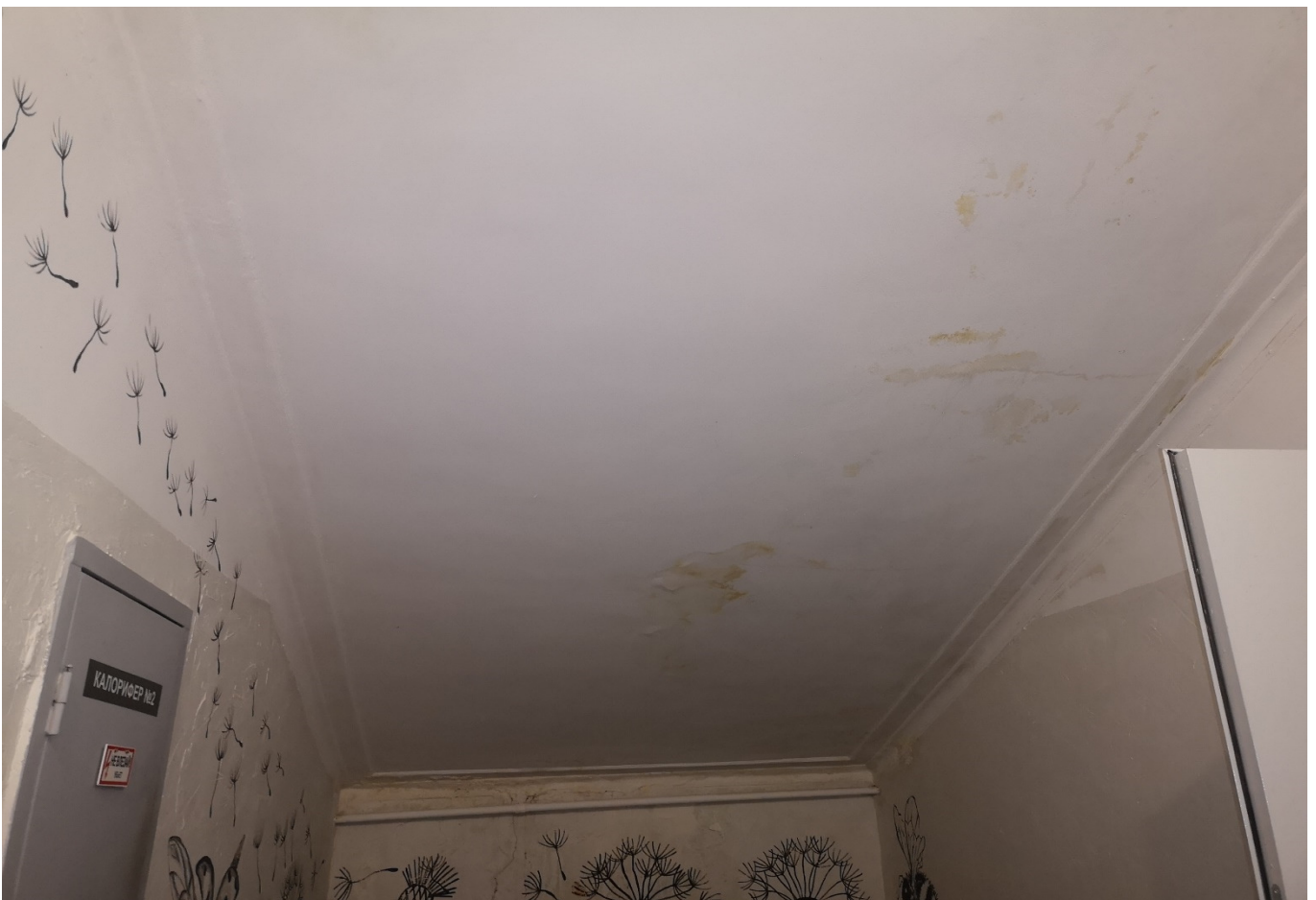
Фото 12. Следы протечек кровли.
